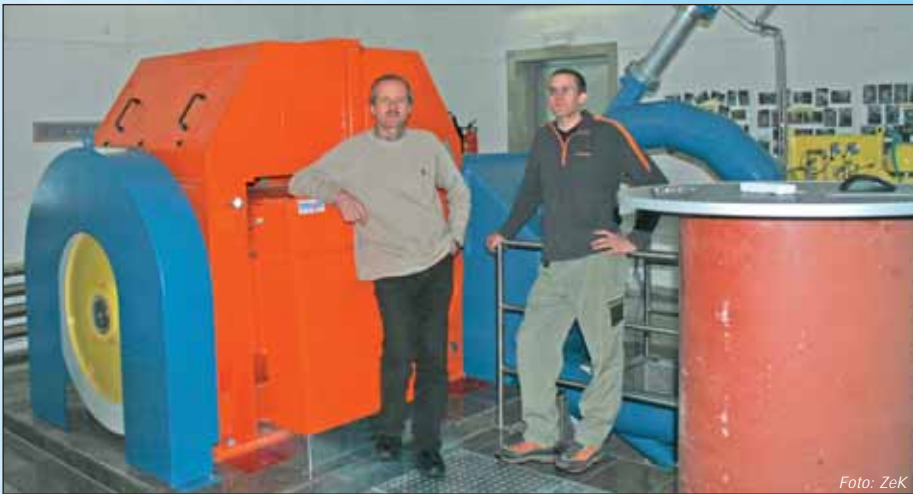
Vater und Sohn Reindl aus Hinterriss im Karwendel sind zurecht stolz auf ihr neues Kraftwerk
