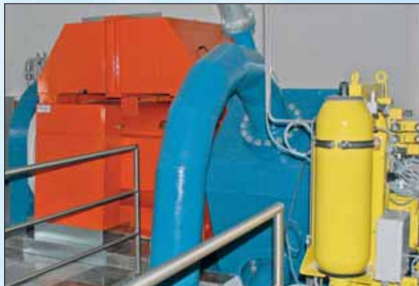
Bewährtes Duo in Orange und Blau: Der Hitzinger-Generator, angetrieben von einer Geppert-Pelton turbine mit 430 kW Leistung.
